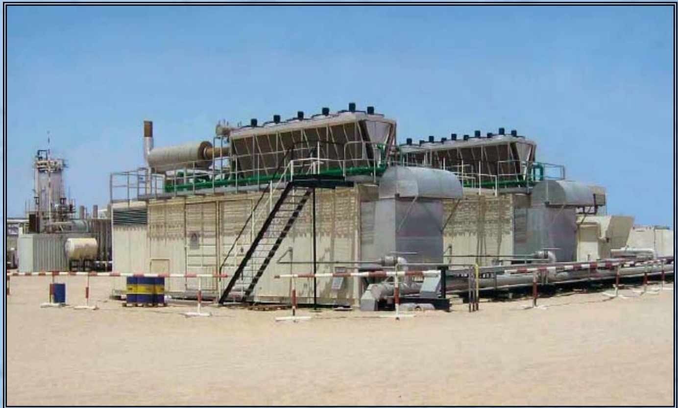
Container-Gas Gensets 2 x 1,2 MW (Waukesha) für Wintershall Stromversorgung für Ölfeld in Libyen
