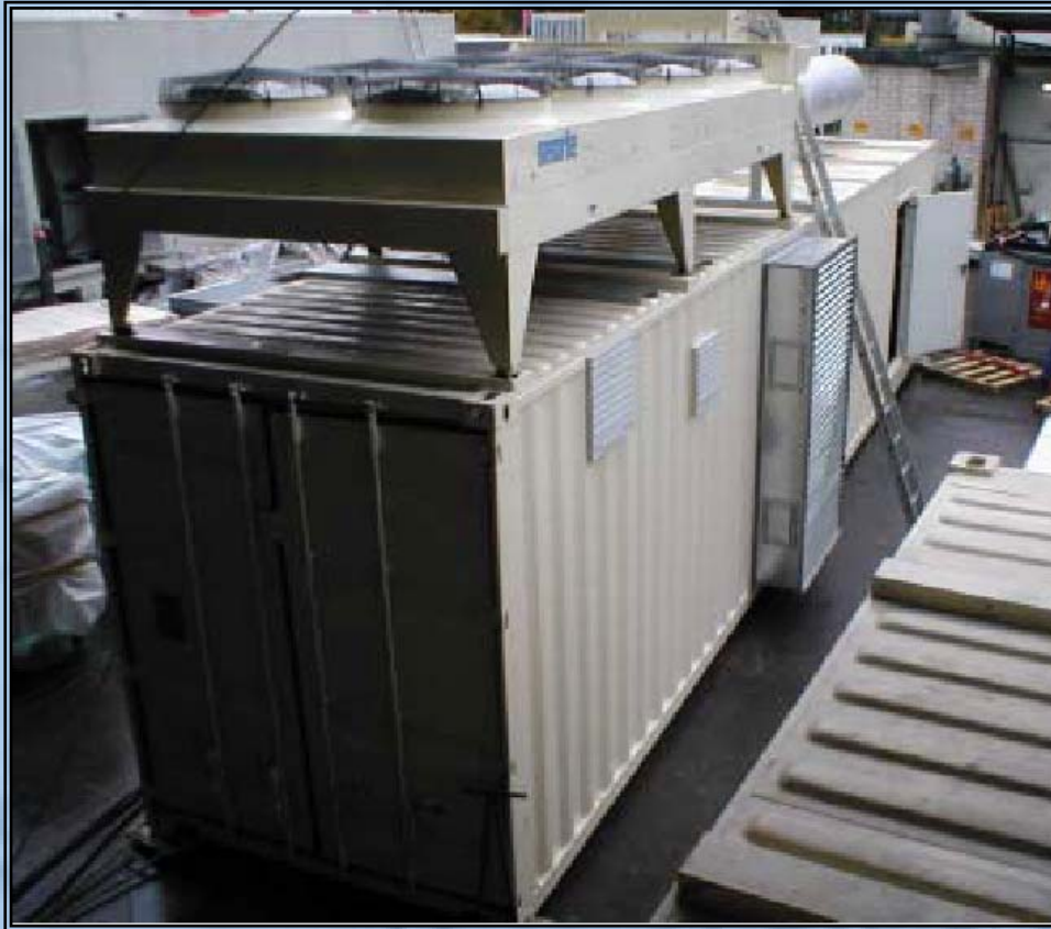
Container-Aggregat mit MTU 16V 4000 Motor für Notstrom- und Netzersatzanwendungen
