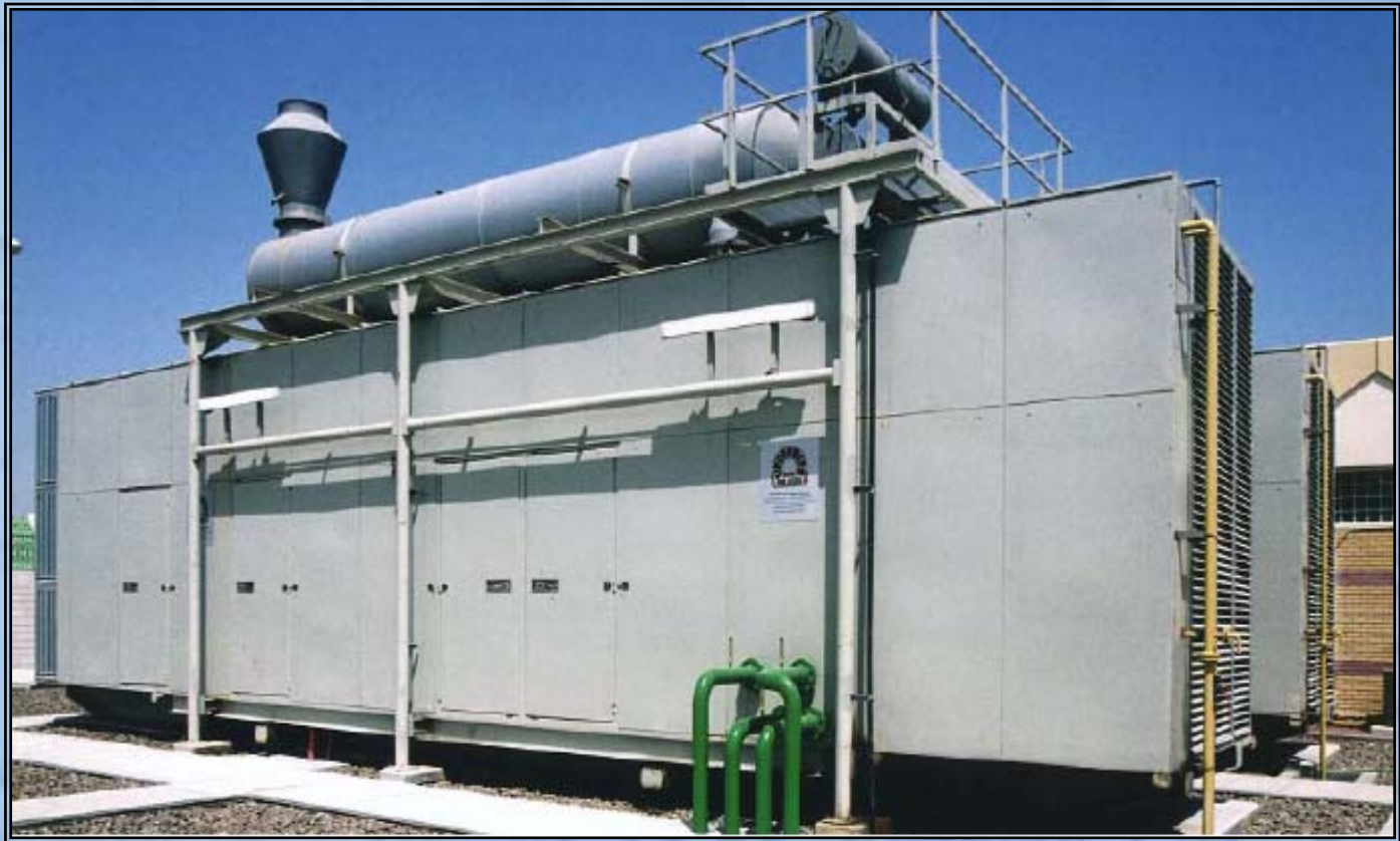
Containeraggregat Deutz BV12M 628, 3500 kVA Container (L x B x H : 20 m x 3,5 x 4,5 m, Gewicht 50 t)
