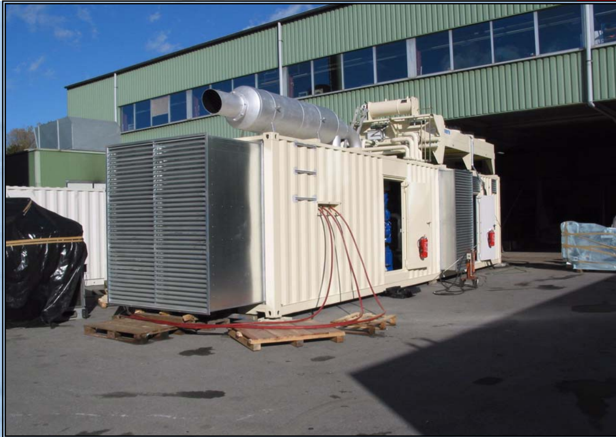
Container-Aggregat mit MTU 16V 4000 Motor für Notstrom- und Netzersatzanwendungen
