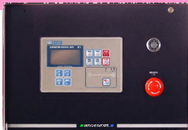
制御盤の操作パネル
